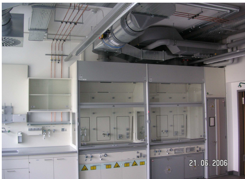
Bild 1: Laborraum mit typischen Be- und Entlüftungssystemen
