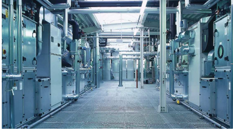
Bild 2: Blick in die Gebäudetechnikzentrale eines Laborgebäudes
